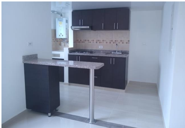
Cocinas integrales instaladas
